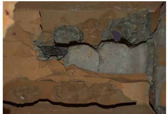
Particolare armatura soletta non rilevabile direttamente
