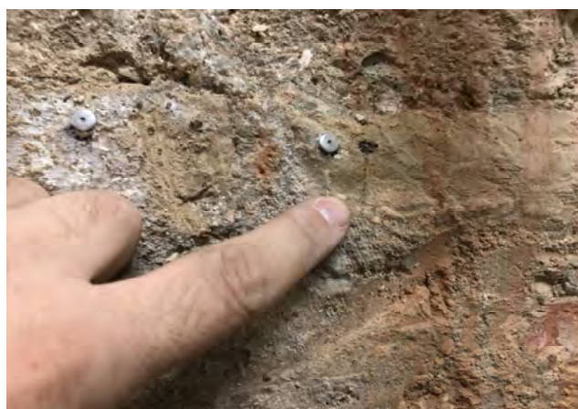
Lesioni di elementi alla pressione massima raggiunta.
