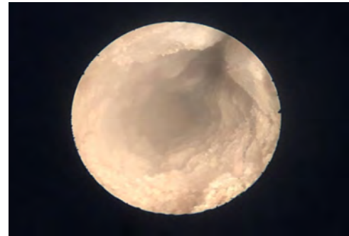
Foto frontale a cm 39 - Corso di malta verticale in buono stato di conservazione
