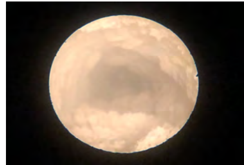
Foto frontale a cm 41 - Corso di malta verticale in buono stato di conservazione
