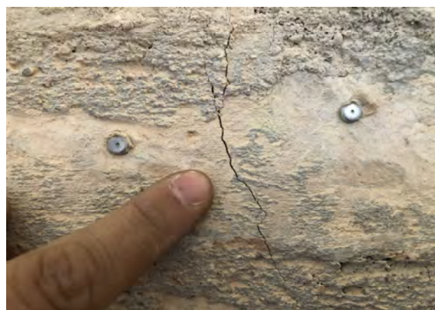
Lesioni di elementi alla pressione massima raggiunta.
