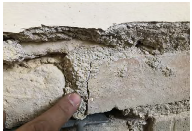
Lesioni di elementi alla pressione massima raggiunta.
