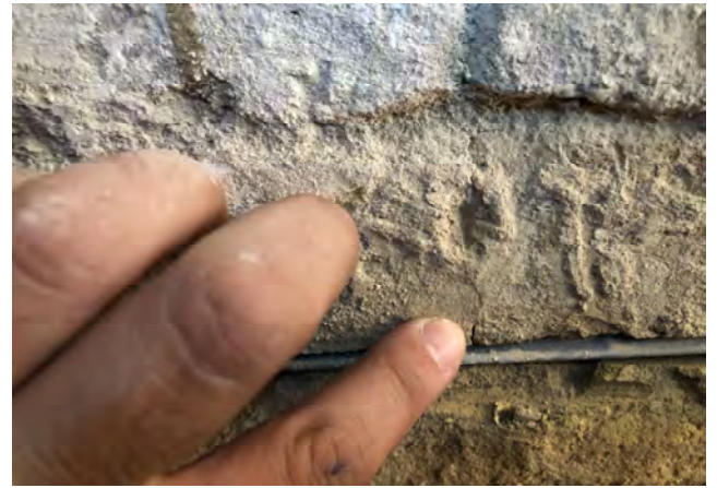
Lesioni di elementi alla pressione massima raggiunta.
